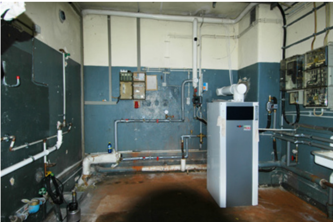
Abbildung 9: Gebäude B1, Schulungsgebäude, Heizungsraum
