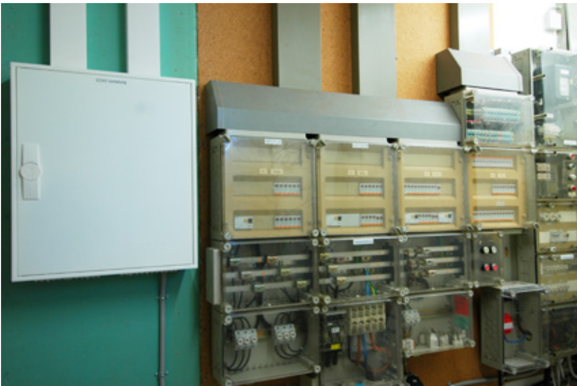
Abbildung 21: Gebäude B3a, Kantine, Erdgeschoss, Technikraum
