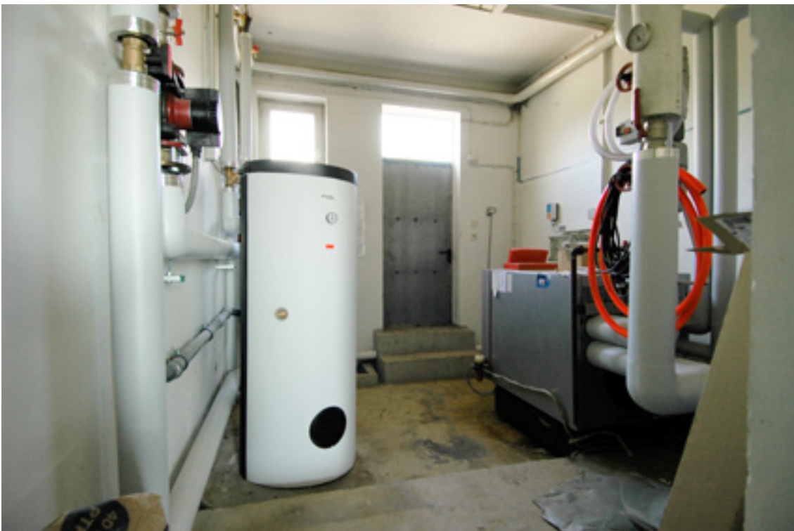
Abbildung 30: Gebäude 3, Bürogebäude, Heizungs- und Technikraum
