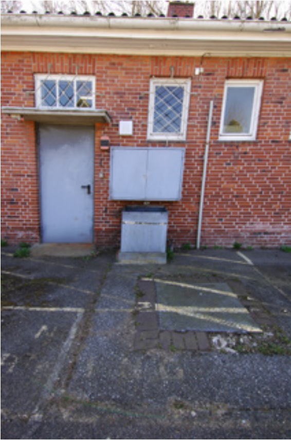
Abbildung 10: Gebäude B1, Schulungsgebäude, Zugang Heizungsraum
